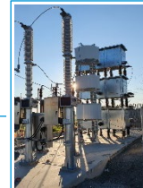
Filtro IP00 Australia Parque Solar
